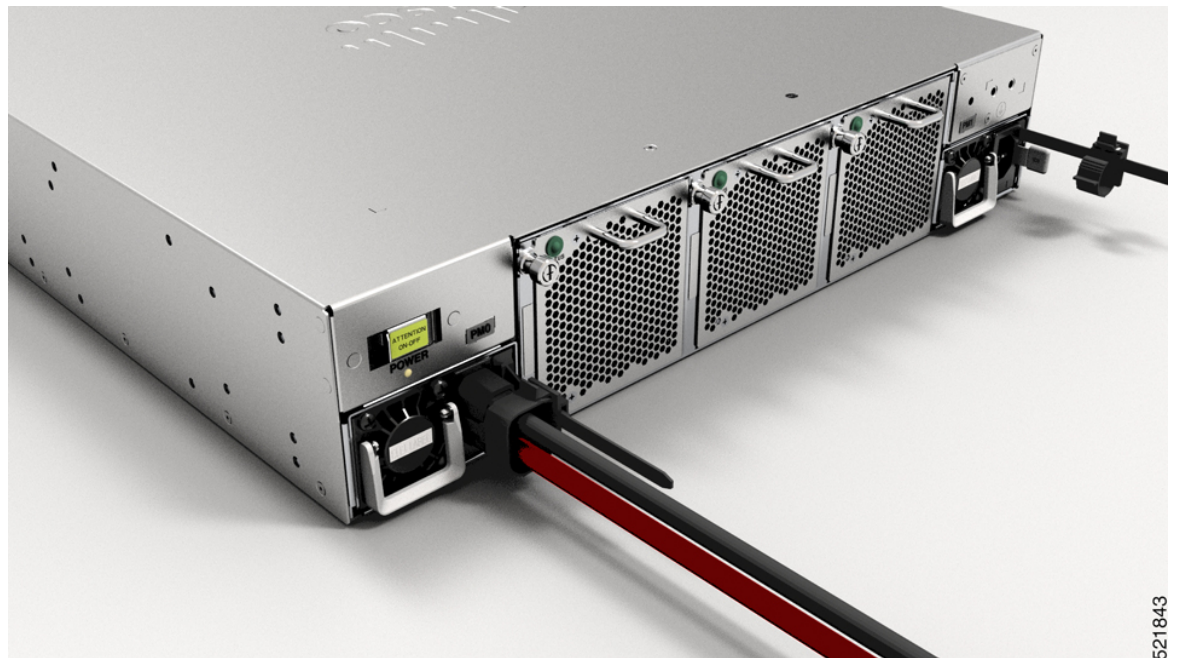
Figura 68: Esquema del cableado de la fuente de alimentación de CC del ASR 9902 de Cisco
